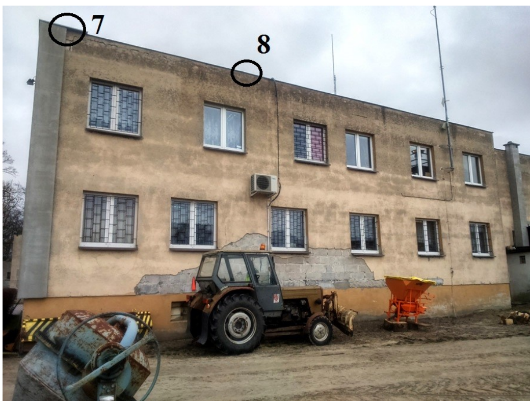
Fot.7. Widok budynku od strony zachodniej. Numerami oznaczono ubytki pod blachą szczytową (aut. Szymon Wójcik).
