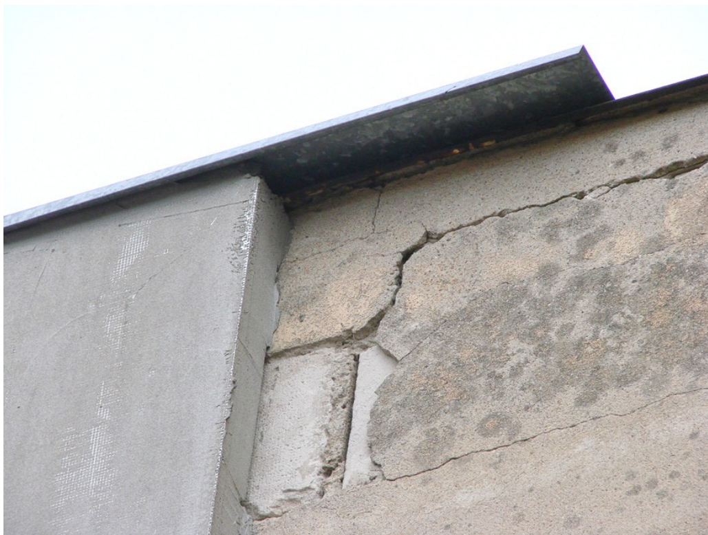
Fot.16. Widok szczeliny nr 7 w zbliżeniu (aut. Szymon Wójcik).
