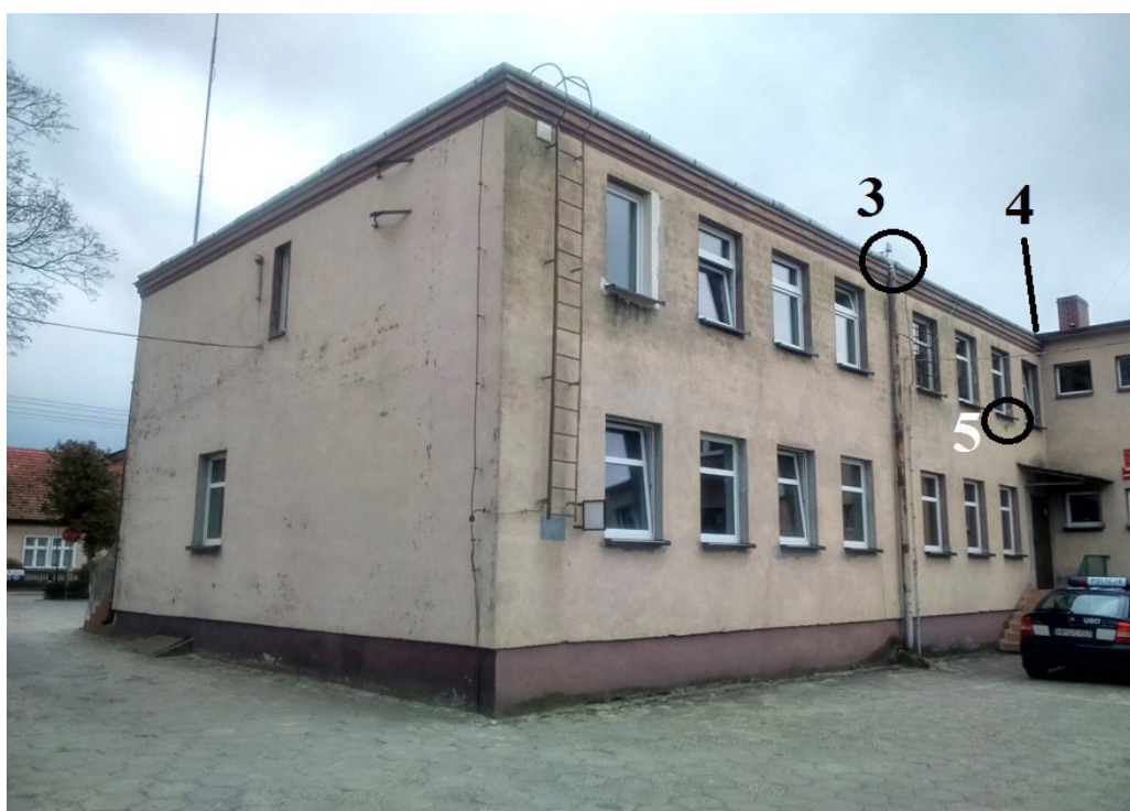
Fot.3. Widok budynku od strony pn-wsch. Nr 3, 4 i 5 oznaczono szczeliny przy rynnach, pod parapetem oraz pod okapem (aut. Szymon Wójcik).
