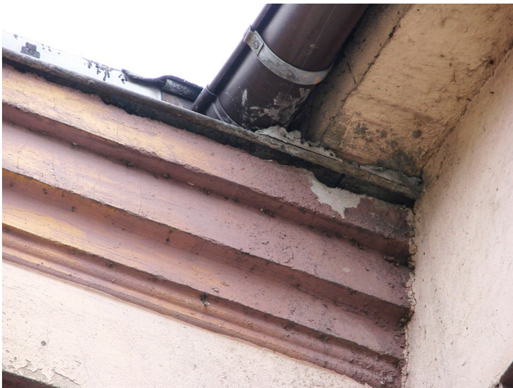
Fot.12. Widok szczeliny nr 4 w zbliżeniu (aut. Szymon Wójcik).
