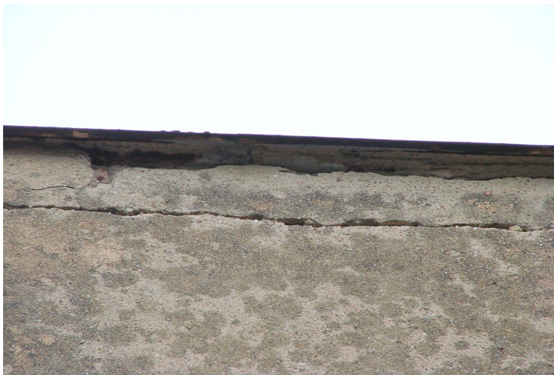
Fot.17. Widok szczeliny nr 8 w zbliżeniu; szczelina ta jednak nie ma prawdopodobnie kontynuacji wewnątrz ściany (aut. Szymon Wójcik).
