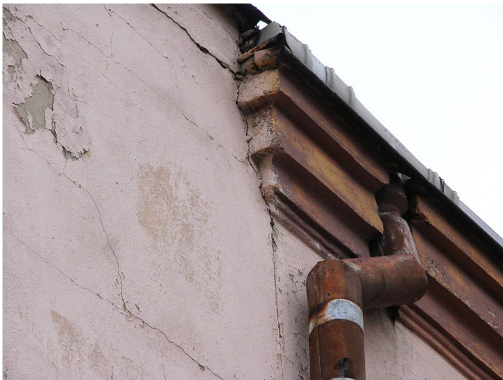
Fot.10. Widok szczeliny nr 1 w zbliżeniu (aut. Szymon Wójcik).
