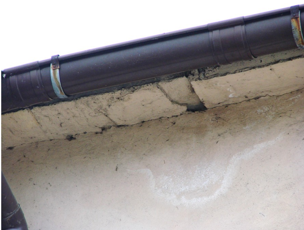
Fot.11. Widok szczeliny nr 6 w zbliżeniu (aut. Szymon Wójcik).
