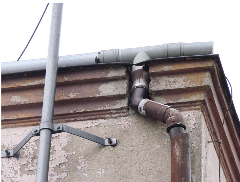
Fot.9. Widok szczeliny nr 2 w zbliżeniu (aut. Szymon Wójcik).
