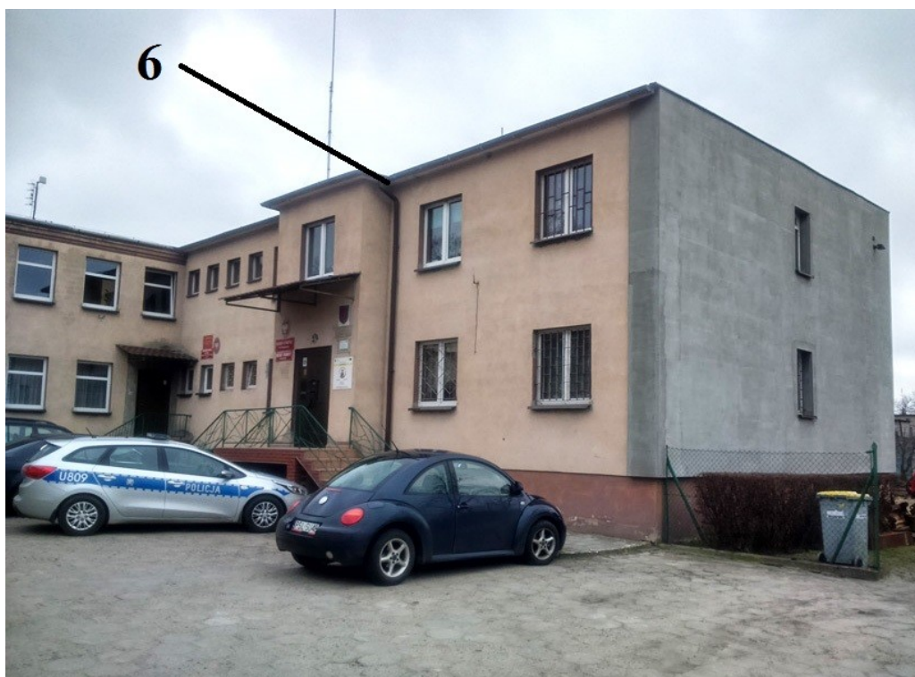
Fot.5. Widok budynku od strony wschodniej, nr 6 oznaczono szczelinę pod okapem (aut. Szymon Wójcik).
