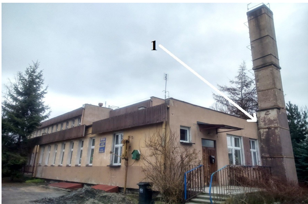
Fot.3. Widok budynku od strony pd-zach. Strzałką nr 1 oznaczono szczelinę przy kominie (aut. Szymon Wójcik).
