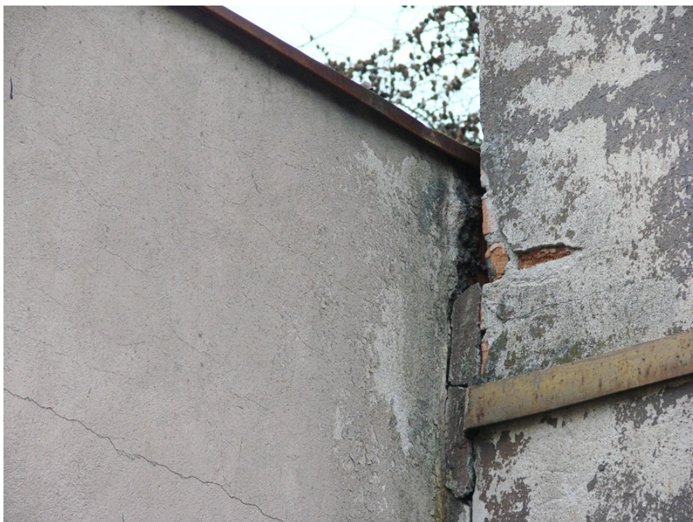
Fot.14. Widok szczeliny nr 1 w zbliżeniu (aut. Szymon Wójcik).
