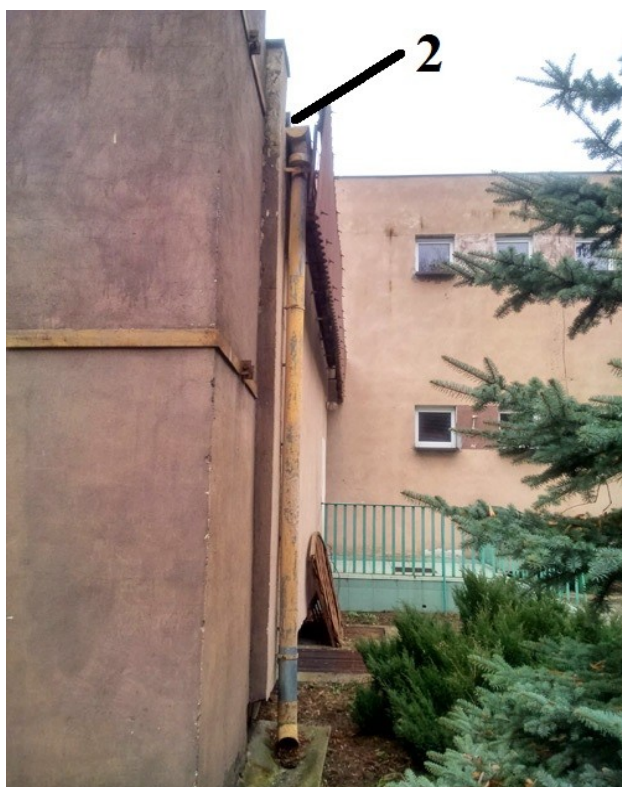
Fot.4. Widok budynku od strony wschodniej. Strzałką nr 2 oznaczono szczelinę przy rynnie (aut. Szymon Wójcik).
