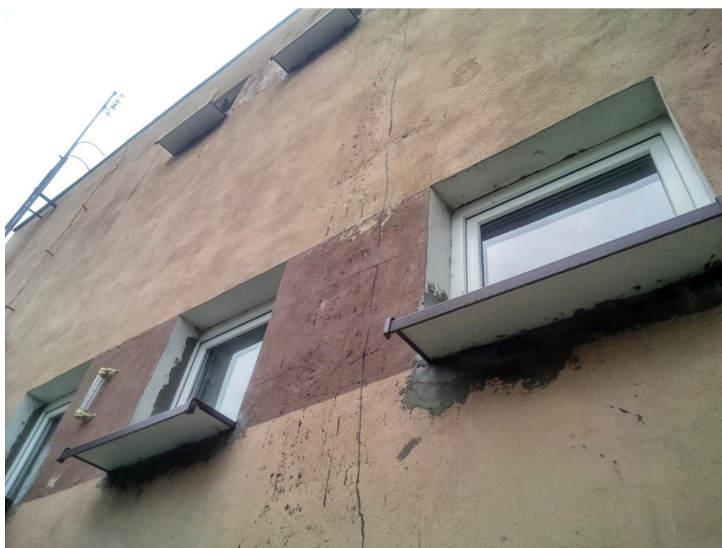
Fot.6. Widok budynku od strony południowej, widoczny jest brak szczelin pod parapetami (aut. Szymon Wójcik).
