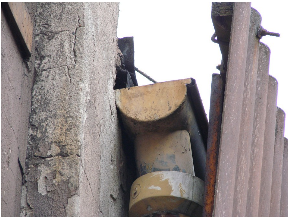
Fot.15. Widok szczeliny nr 2 w zbliżeniu (aut. Szymon Wójcik).
